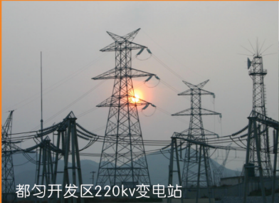
都匀开发区220kv变电站
